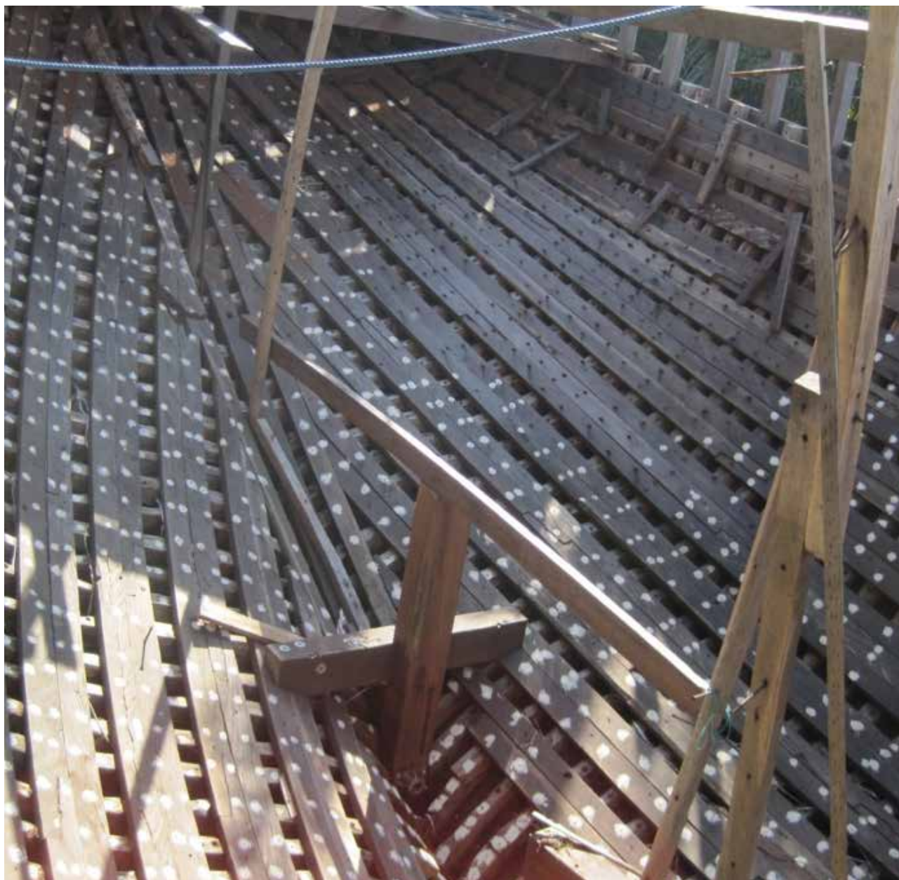
Cale en Ulin (= Billian) d'un «perahu pinisi» (Goélette / Schooner) en construction (navire traditionnel de transport domestique de marchandises) - Chantier naval traditionnel Bugis Bira, Bulukumba, Célèbes du Sud, Indonésie (© Benoît Gommet, France Timber)
